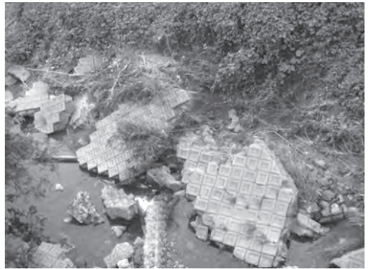
図5 崩れたコンクリート壁
